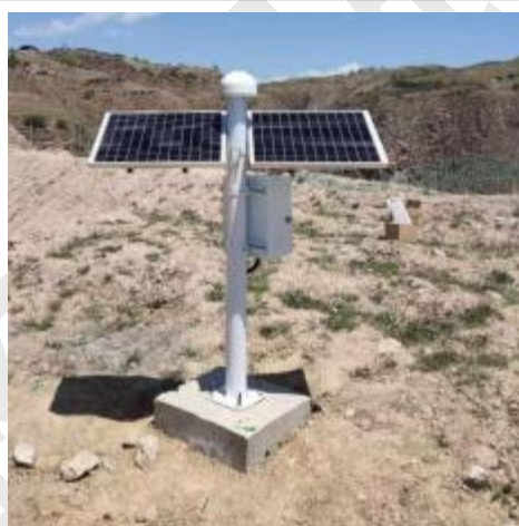
GNSS 监测基准站
